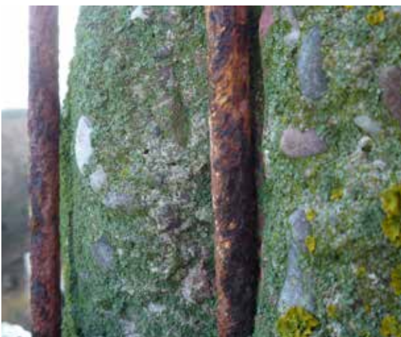
Schäden am Turm und am Turmkreuz werden sichtbar
